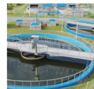
Очистные сооружения, для аэрации
